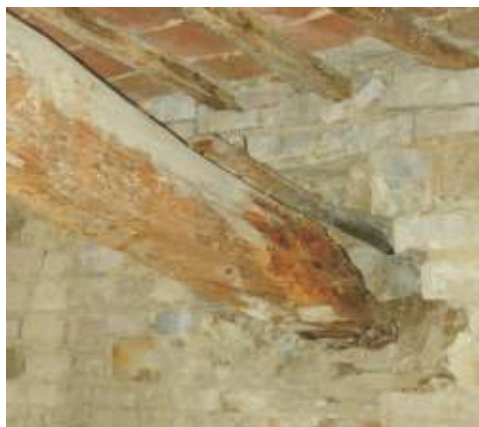
Viga degradada no suporte
